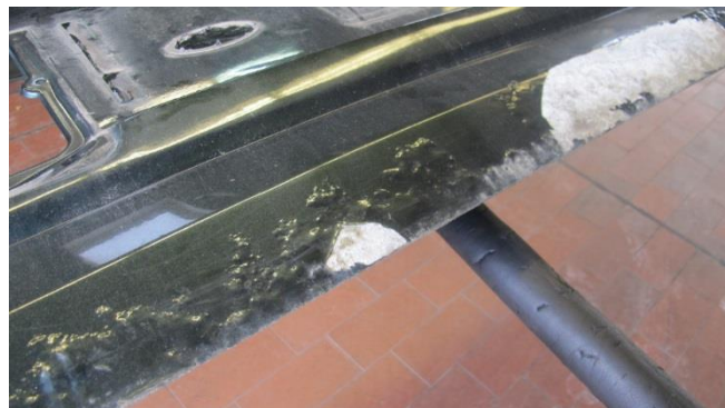
Bild : Kontaktkorrosion AL/ST
