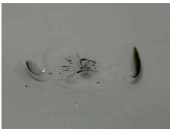
nicht fachgerecht instandgesetzt/ Lufteinschlüsse vorhanden
