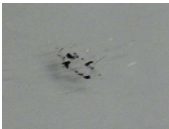
nicht fachgerecht instandgesetzt/ Lufteinschlüsse vorhanden
